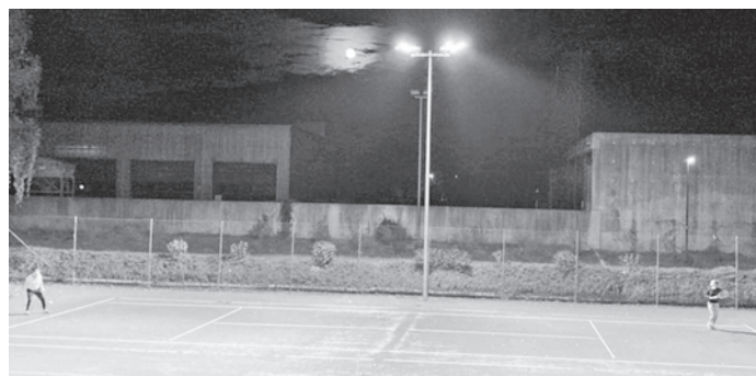
Neue LED-Flutlichtanlage für Plätze 4 und 5.
