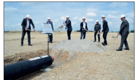
Mai: Mit dem Spatenstich im Lerchenwinkel beginnen die Arbeiten für den Anschluss an die Geothermie, die dort in Zukunft für Fernwärme sorgt.
