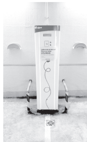
Ladesäule im P&R-Gebäude außer Betrieb
